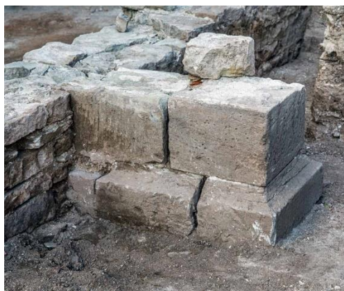
Abbildung 1: Gut erhaltener Strebpfeiler der Nordfassade des Kreuzgangs aus sauberem Quadermauerwerk. Teilweise wurden hier Werksteine des älteren romanischen Kreuzgangs wiederverwendet.
